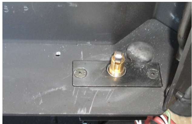
Illustr. 37: Door switch installed
